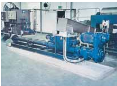
Насосы seeplex BTI 17-48 . Продукт: обезвоженный шлам из центрифуги с примерно 25% сухого остатка.
