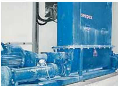
Насос seerex BTI 10-12. Продукт: обезвоженный шлам с 20% сухого остатка из ленточного сетчатого пресса. Особенность: Шлам дополнительно обрабатывается известью в насосе и доводится примерно до 35% сухого остатка. Процесс контролируется при помощи системы управления seerex SLCO.
