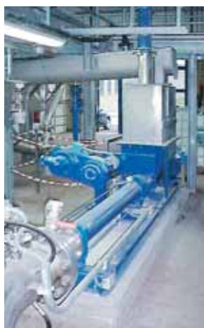
Насос сеерех VTI 35-24. Продукт: обезвоженный шлам с 20% сухого остатка из центрифуги. Особенность: В съемную воронку насоса добавляется известь. Шлам с 35% сухого остатка транспортируется к месту хранения шлама. Напорный трубопровод выполнен с местами впрыска смазки с целью окращения потерь давления.
